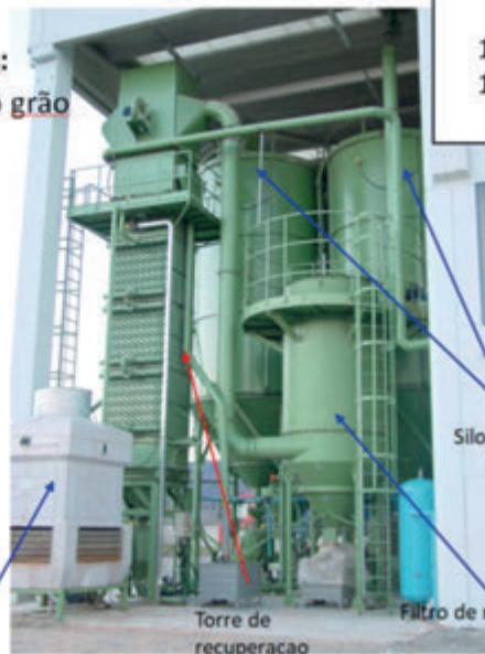
Torre de Resfriamento
